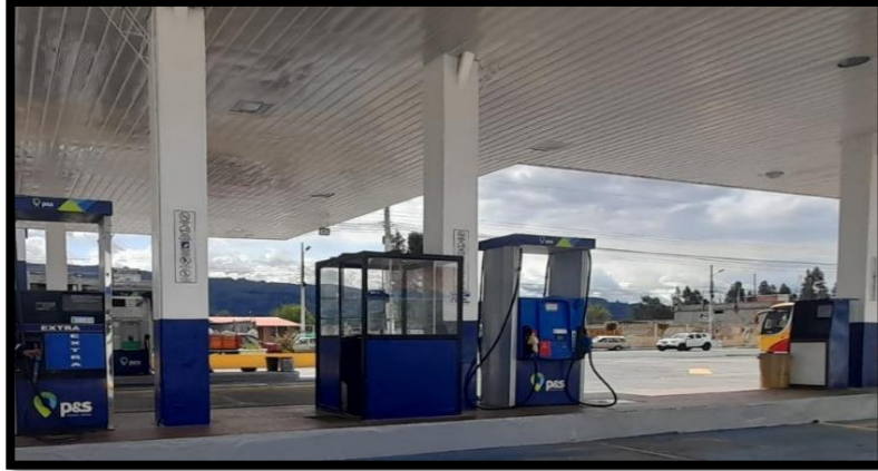
Surtidores Gasolinera P&S
