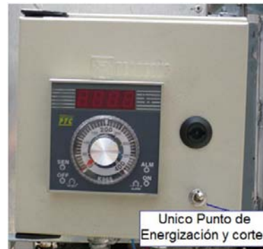
Figura 5.31 Apagado de emergencia y cierre de alimentación de gas.
