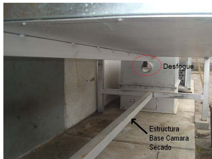
Figura 5.13 Estructura de la cámara de secado.
