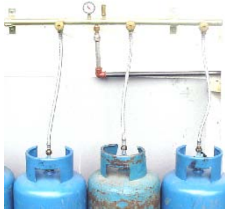
Figura 5.33 Distribución de combustible alejado del equipo y el operador
