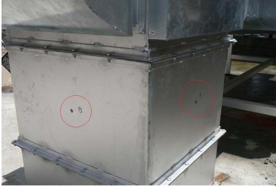
Figura 6.12 Marcación de puntos de medición - Cámara de Combustión.
