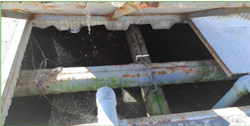
FIG. 6 Tanque de almacenamiento
