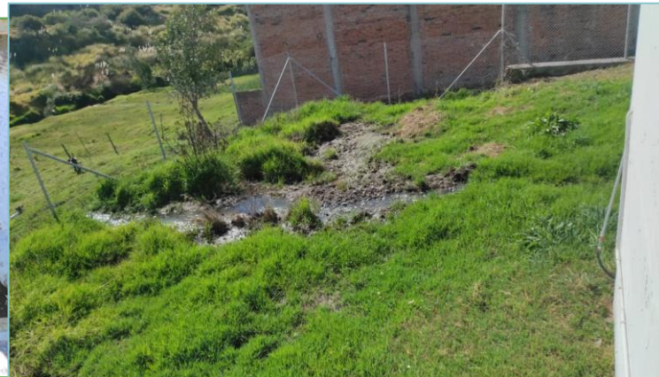
FIG. 8 Descarga de agua
