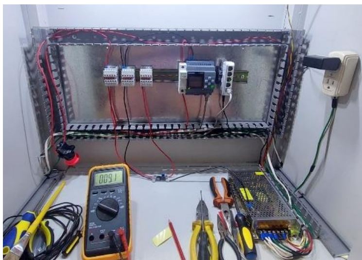
Cableado eléctrico módulo 1
