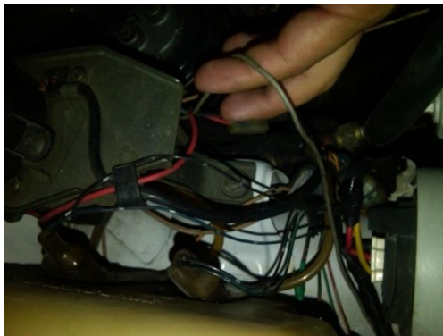
Fuente: Patricio Pazmiño y David Cerda Figura 4.43 Cableado de Pulsadores
