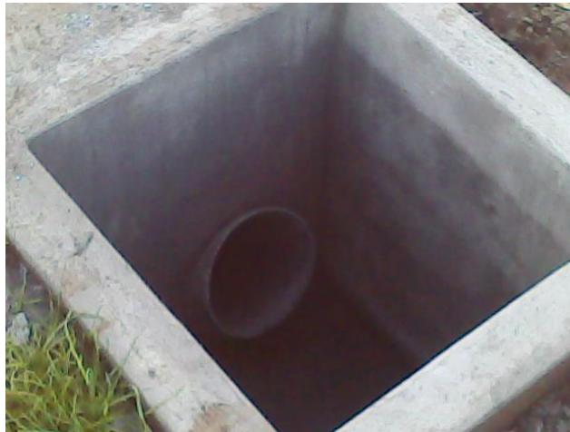
Figura 2.14 Tanque de descarga
