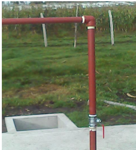
Figura 2.18 Tubería de conducción de biogás.
