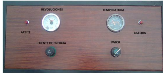
Figura 3.57 Tablero de Control
