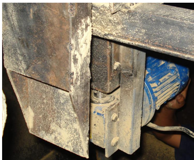
Figura 2.16. Soporte del motorreductor del cono de descarga
