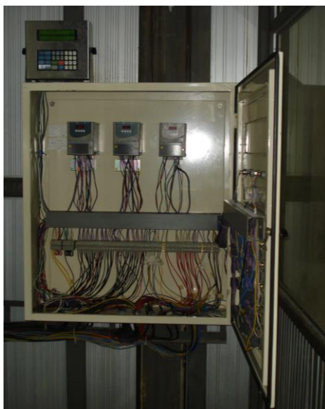
Figura 4.12. Instalación de los equipos y accesorios en el tablero de control
