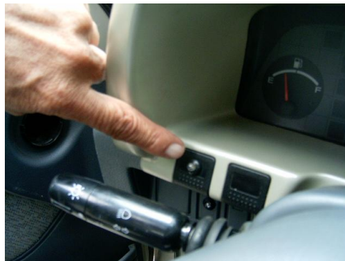
Figura 4.8.- Instalación del elemento de alarma visual “LED”.
