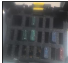
Figura 3.37 Caja de fusibles
