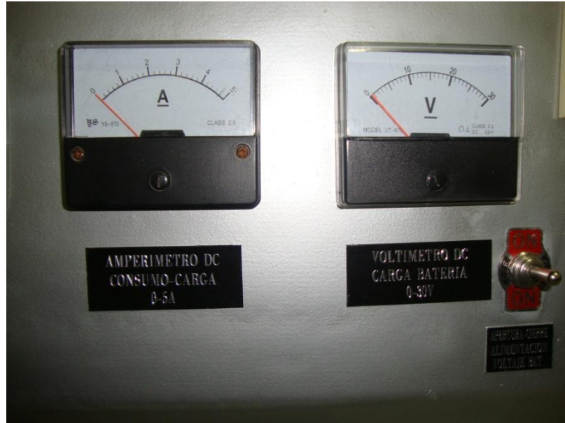
Amperímetro Carga – Voltímetro de Batería – Switch de Alimentación al Sistema de Alimentación
