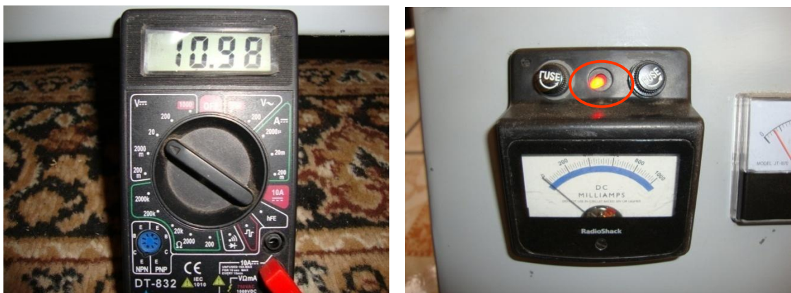
Figura 4.18 Medición del Voltaje de Batería y Cambio de Color en Led Indicativo
