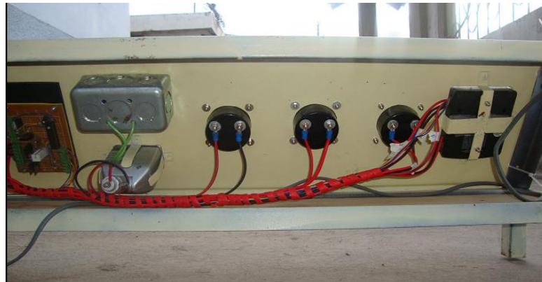
Figura 3.25 Fijación y Cableado de Dispositivos
