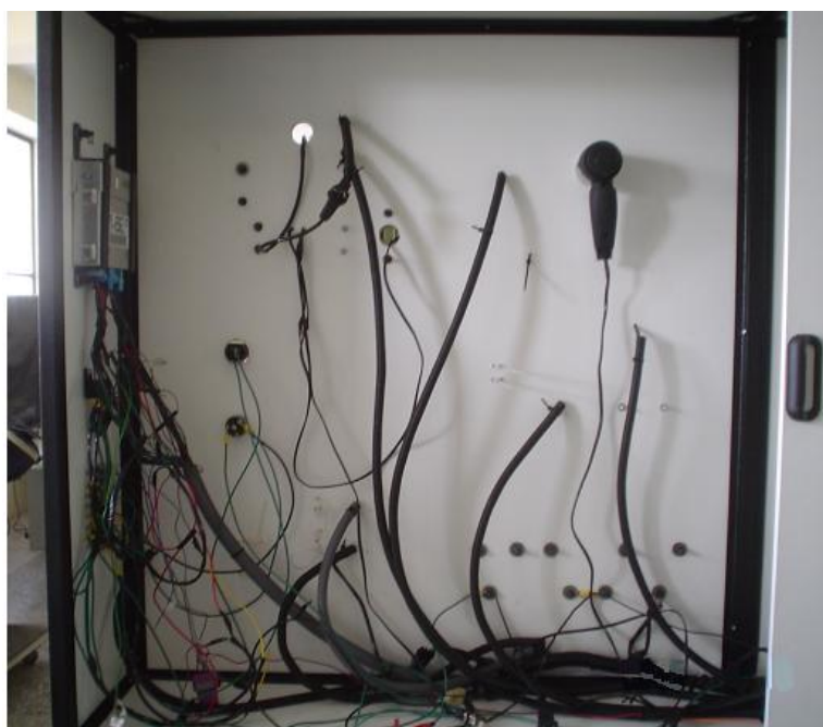
Figura 4.21 Cableado del módulo
