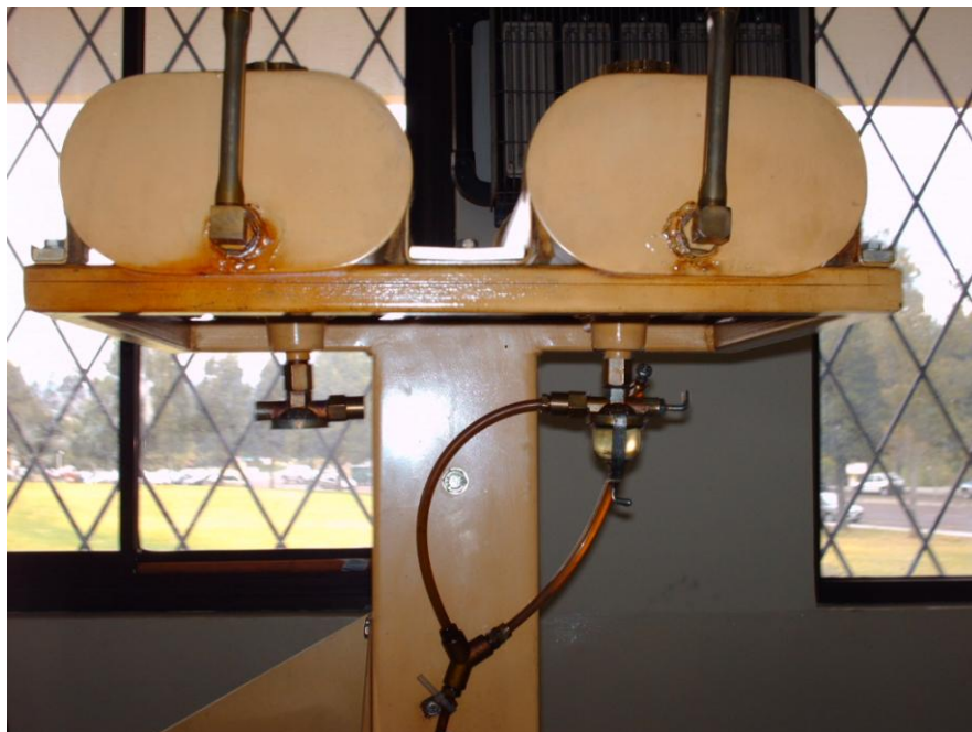
Fig.3.2 Tanques de combustibles
