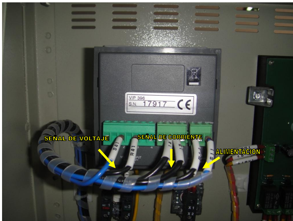
Figura 3.9 – Señales y alimentación del analizador de energía
