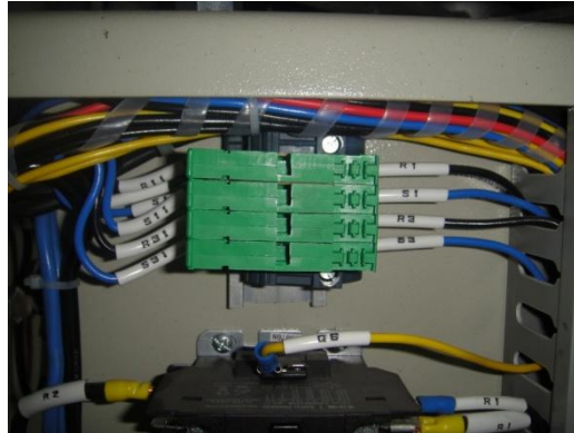
Figura 3.12 – Fusibles y Portafusibles F1 y F2
