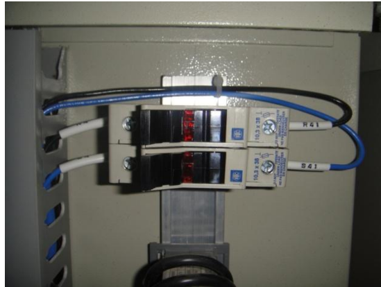
Figura 3.18 – Fusibles y Portafusibles F5 y F6
