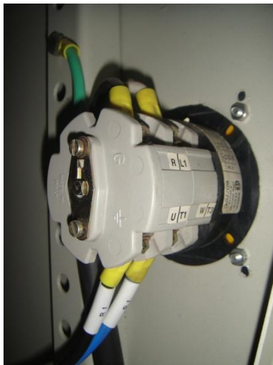
Figura 3.11 – Switch de servicio
