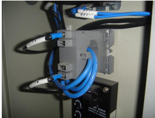
Figura 3.22 - Transformador de corriente TC2
