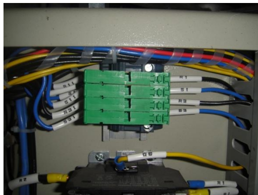
Figura 3.16 – Fusibles y Portafusibles F3 y F4
