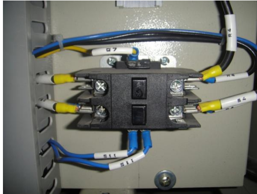
Figura 3.19 – Contactor de salida
