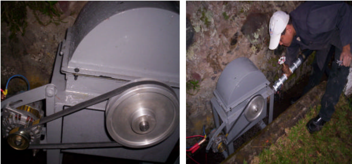
Figura # 5-40 Acoplamiento alternador turbina
