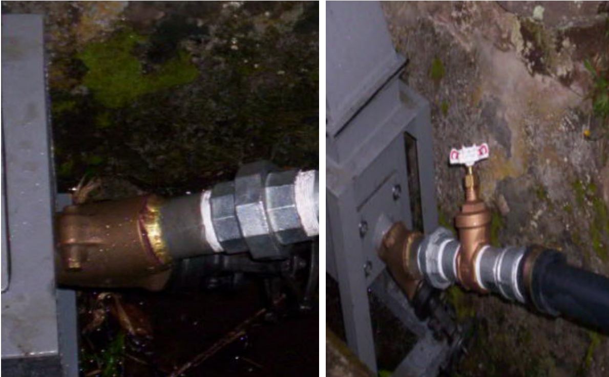
Figura # 5-38 Turbina – Tubería de Presión y válvulas de protección
