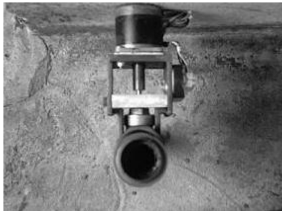
Figura 3.21 Motor PAP acoplado a Válvula tipo compuerta
