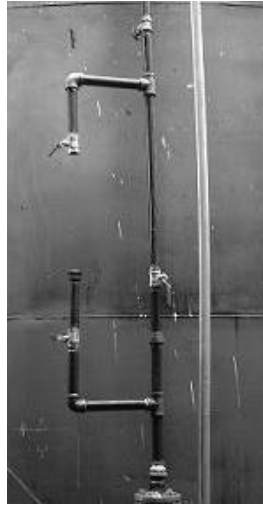
Tubería de vapor tanque TKP
