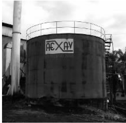
Figura 1.40 Tanques de Almacenamiento
