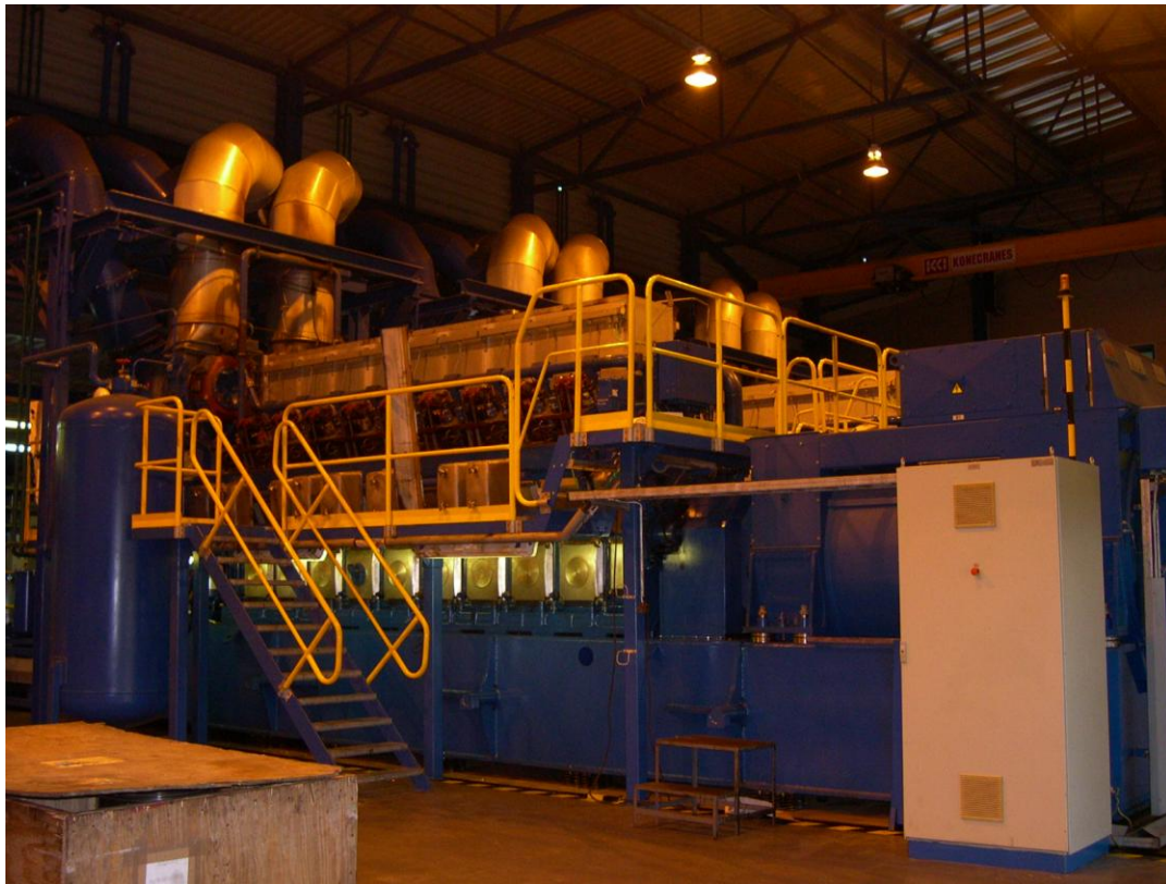
Fig 1.5 Planta de generación a crudo Wartsila - Repsol YPF Ecuador.
