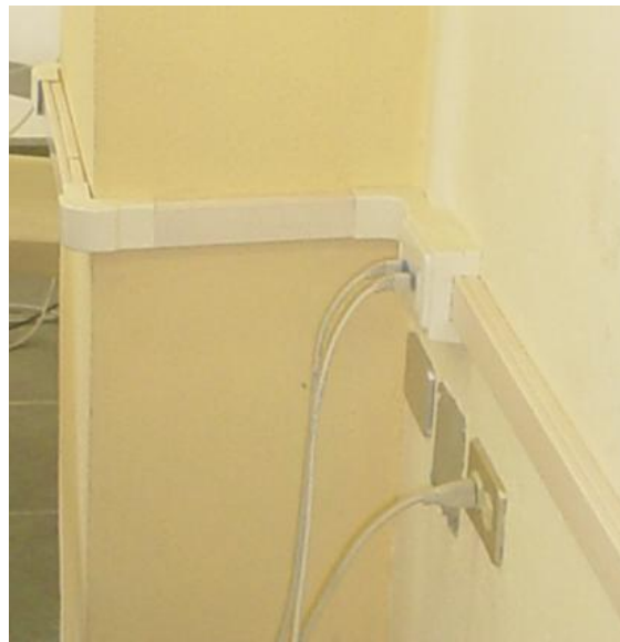
Fig. 3.7 Canaletas de la Red Lan
