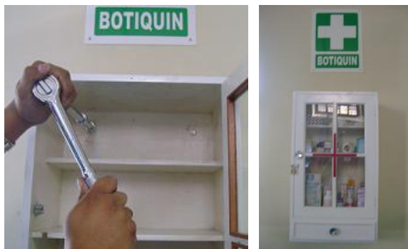
Figura 5. 30. Instalación del Botiquín
