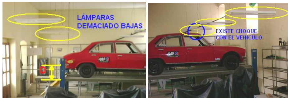
Figura 5. 1. Lámparas fluorescentes mal ubicadas
