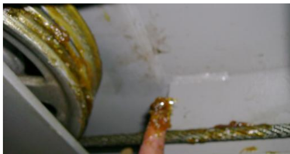
Figura 6. 85. Limpieza y lubricación de cables
