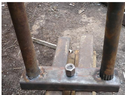
Figura 5.43. Base del Banco Cummins.
