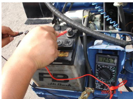
Figura 3.15 Medición de Voltaje
