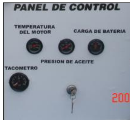
Figura 3.41. Tablero de instrumentos
