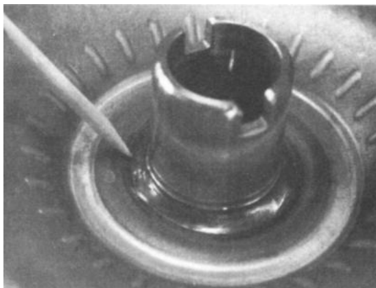
Fig. 4.6 Grietas en la zona de soldadura del cubo
