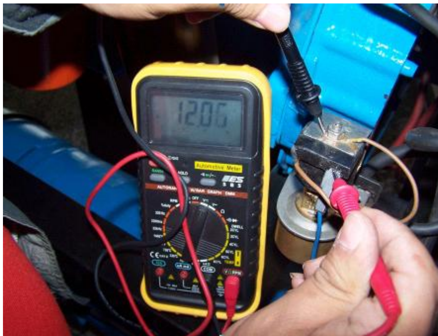
Figura. 4.48 Voltaje de activación de la electroválvula de gas
