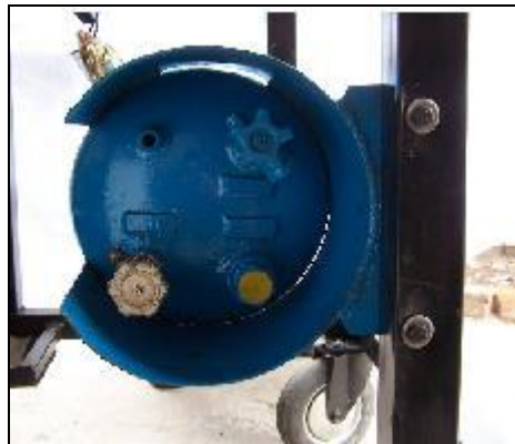
Figura. 4.2 Controles del depósito GLP
