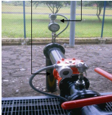
Figura. 2.35. Transmisores de presión y temperatura.
