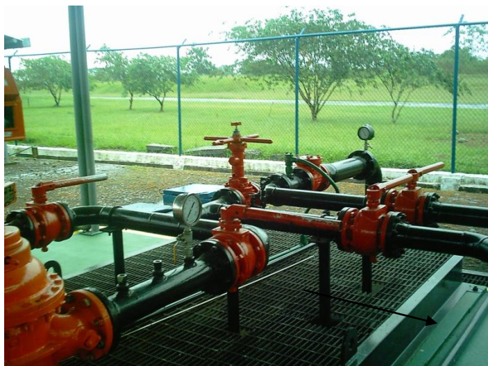
Figura 3.3. Puesta en línea medidor - Probador.
