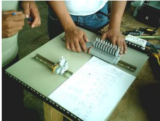
Figura 2.25. Panel de conexiones JB - 02.
