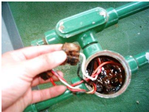
Figura 2.29. Daños del cable.
