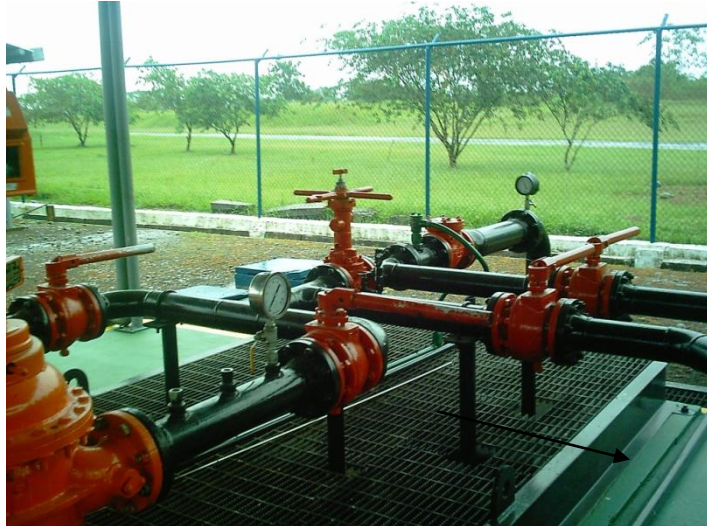
Figura 3.3. Puesta en línea medidor - Probador.
