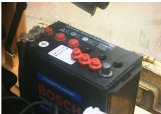
Fig. 7.9 Inspección del electrolito de la batería
