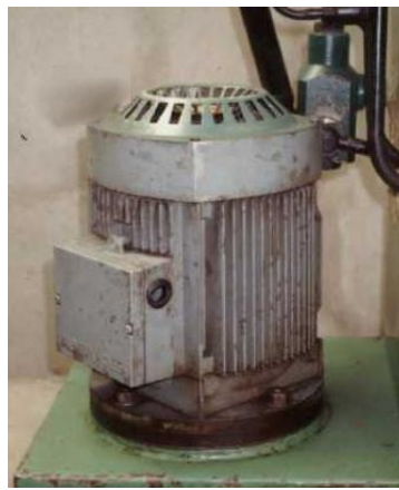
Motor eléctrico de la bomba del sistema oleohidráulico
