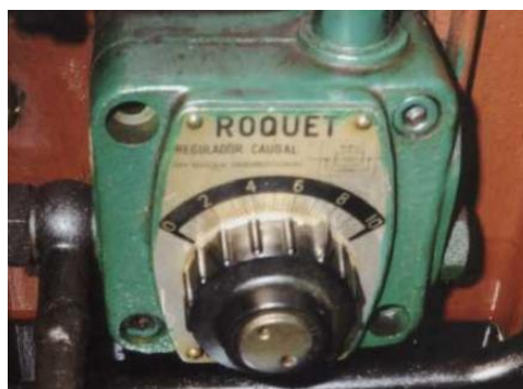
Regulador de caudal del sistema oleohidráulico
