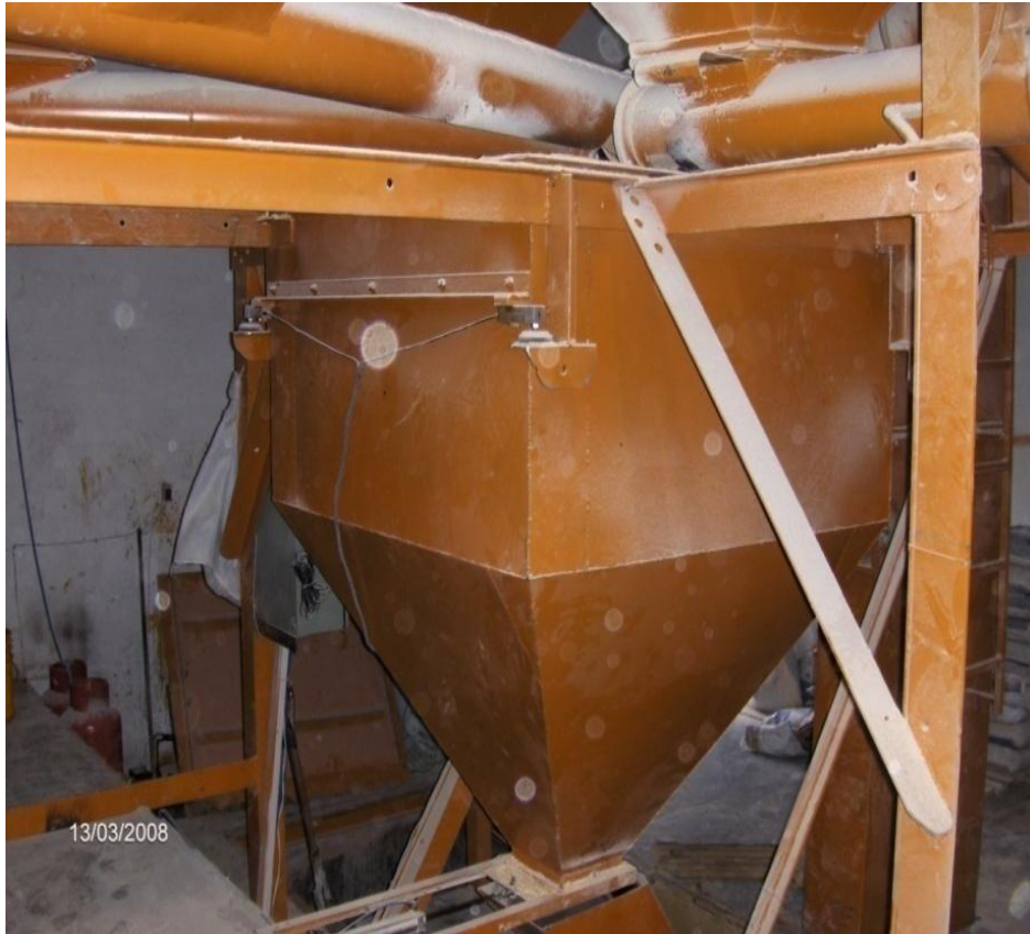
Figura 2.7 Tolva de Dosificado
