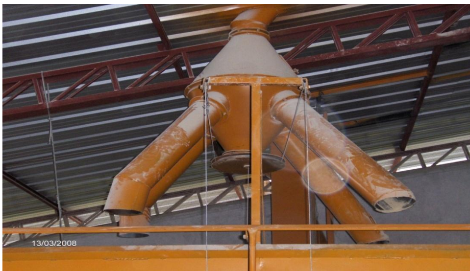
Figura 2.11 Distribuidor Secundario y rueda de Accionamiento Mecánico.
