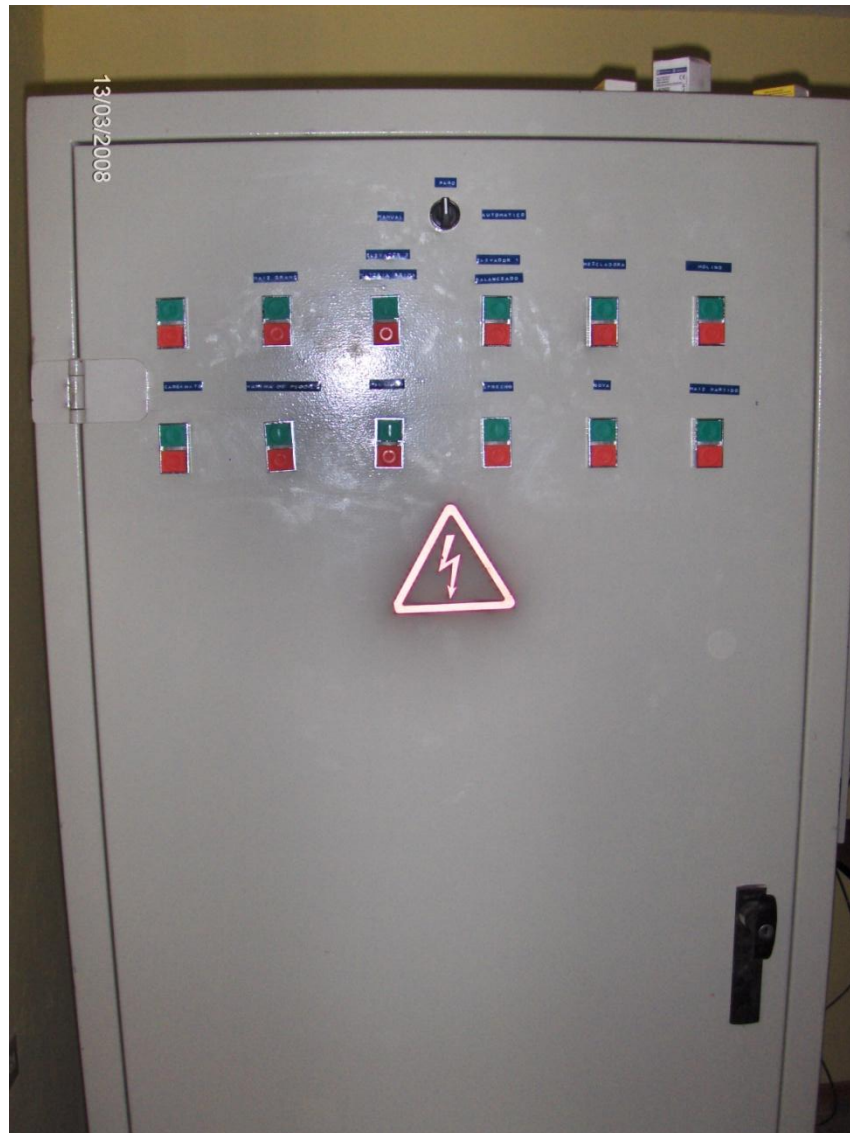
Figura 2.21 Puerta de Acceso al Tablero Principal
