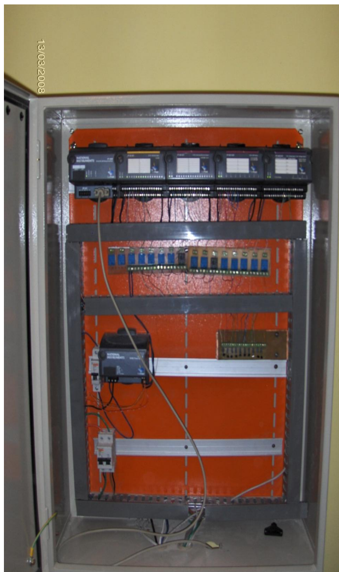
Figura 3.31 Tablero de Adquisición de Datos
