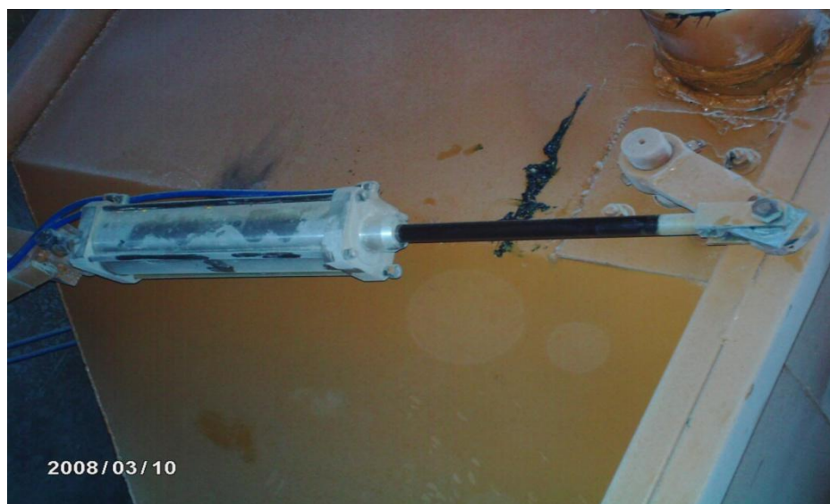
Figura 3.26 Cilindro Neumático de la Puerta de la Mezcladora
