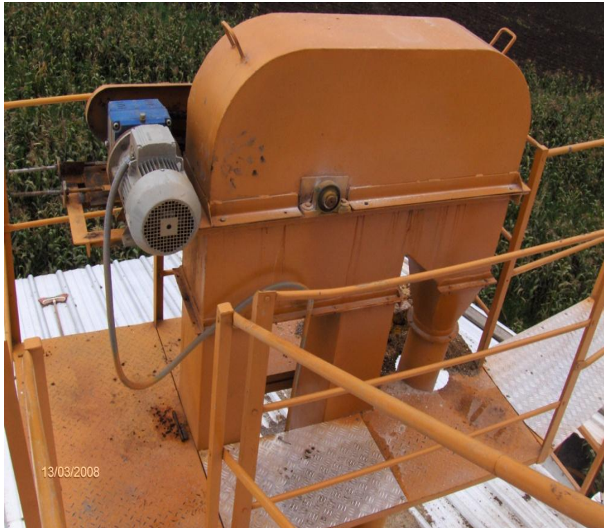
Figura 3.24 Ubicación del Motor del Elevador de Cangilones
