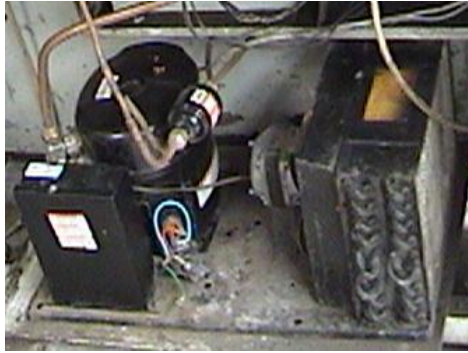
Figura 3.21. Sistema de refrigeración.
