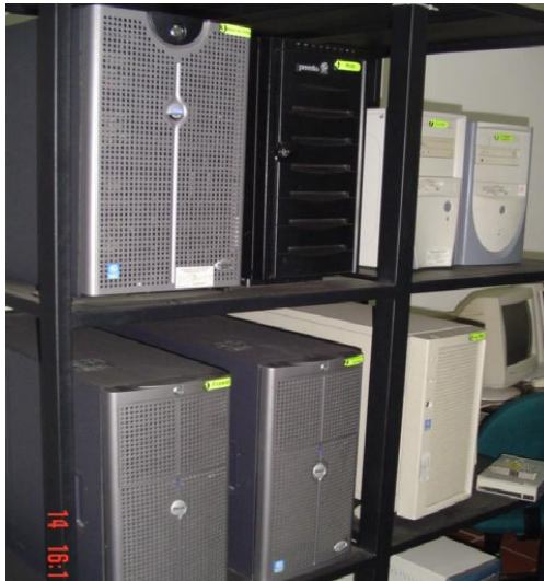
Figura 4.4 Sala de Servidores.
