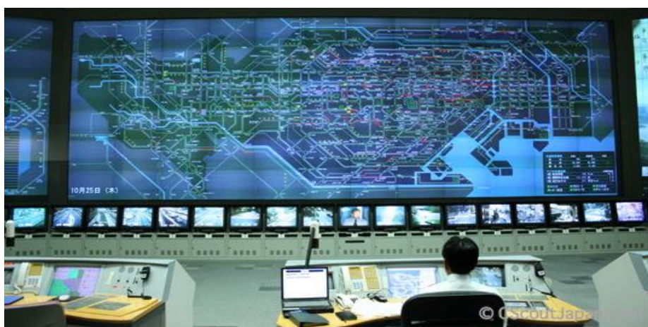
Fig. 2.11 Centro de Control de video vigilancia
