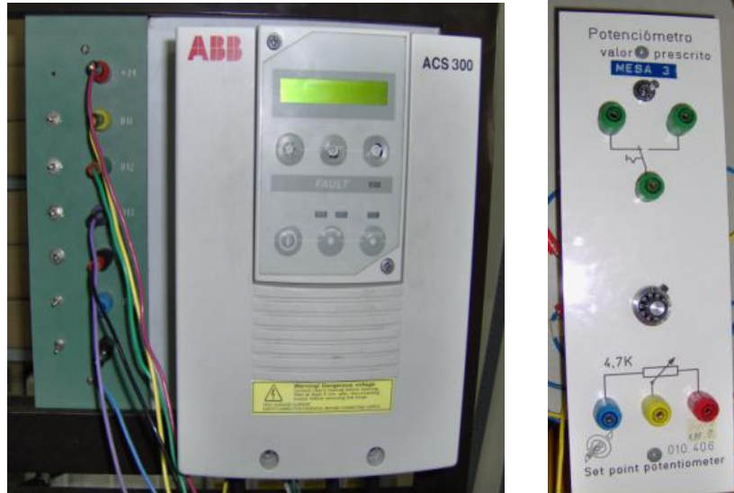
Figura 4.11: Potenciómetro y Tarjeta de señales digitales de mando remoto para variador ABB
