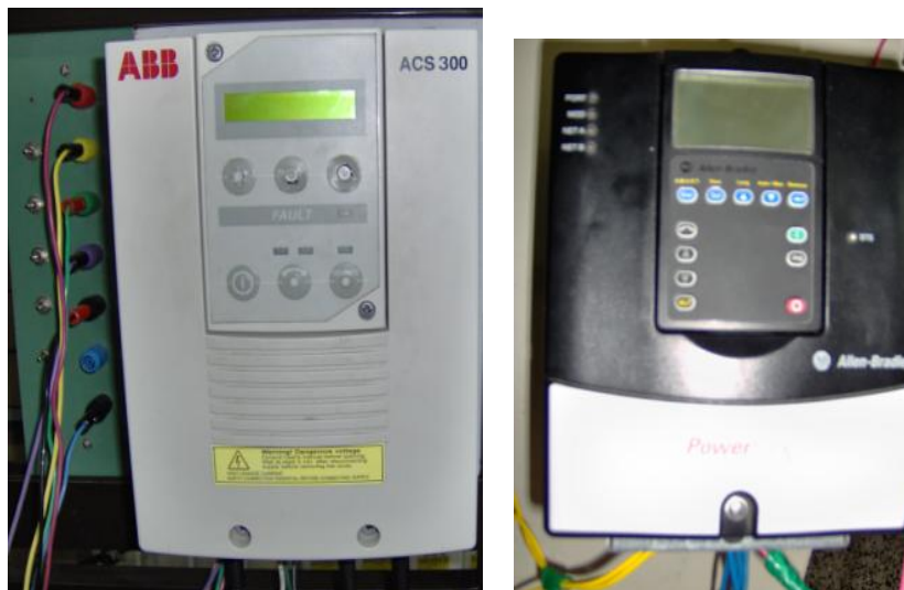
Figura 3.21: Variadores de frecuencia ABB y Power Flex 70
