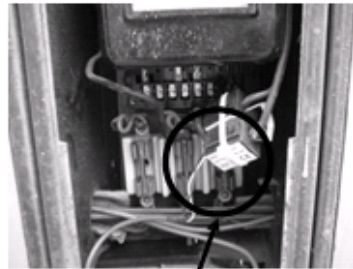
Inyección de Señal PLC en Medidor de cliente
