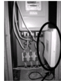
Repetidor de Señal PLC en Baja Tensión
