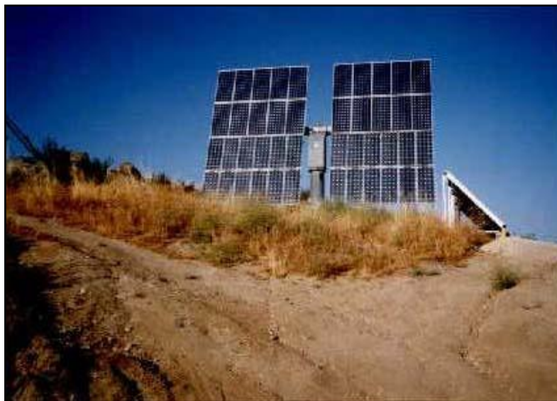
Figura 1.3: Seguidor solar con 44 paneles fotovoltaicos (SOLÉNER)
