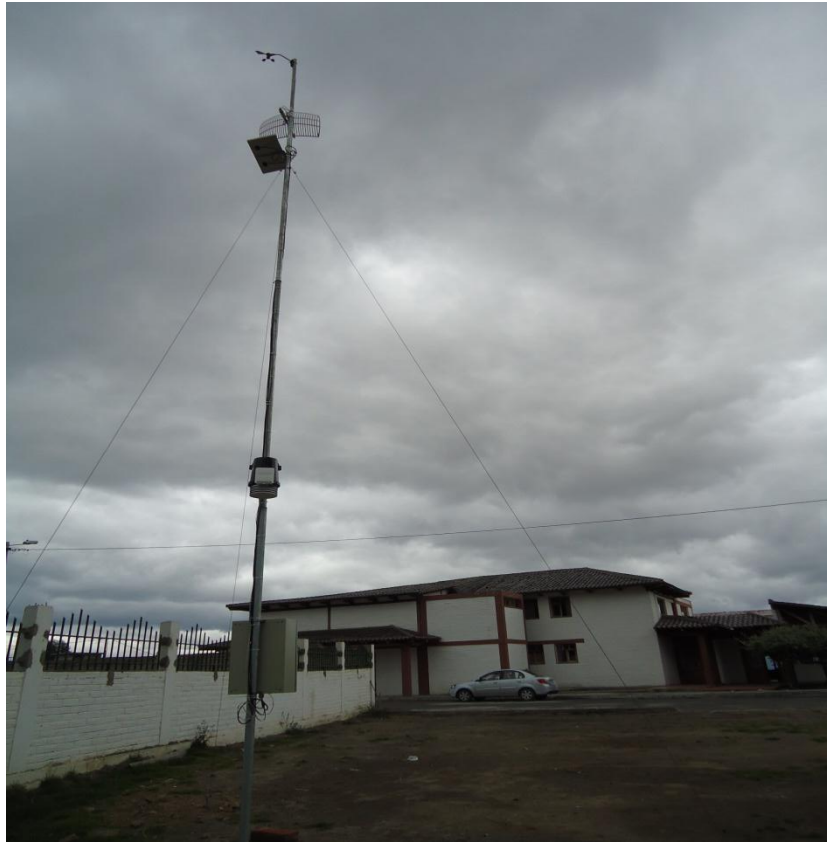
Figura 3.8 Anemómetro instalado en el centro de eventos Sinchaguasín
