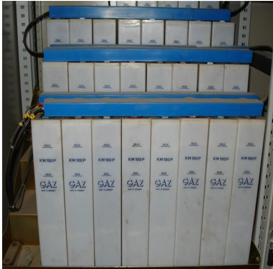
Figura 3.7 Banco de baterías
