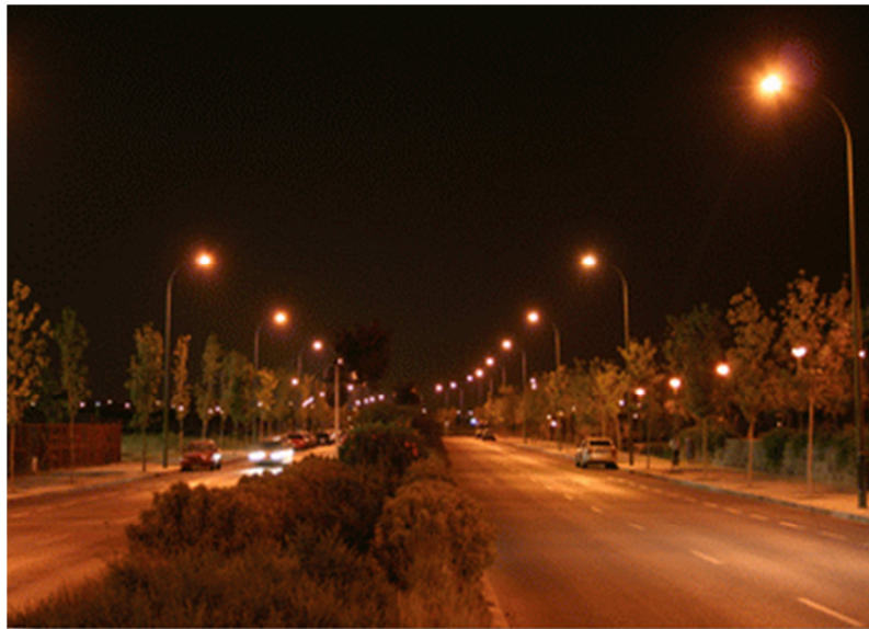
Figura 2. 20 Luminarias de vapor de sodio de alta presión.
