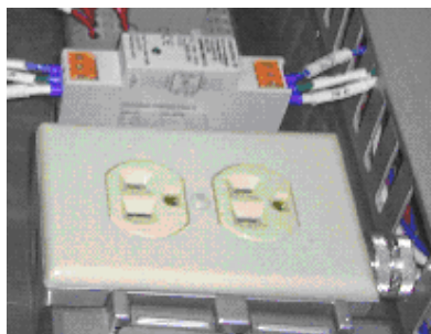
Figura 4. 6 Supresor de transientes y tomacorriente en panel de control
