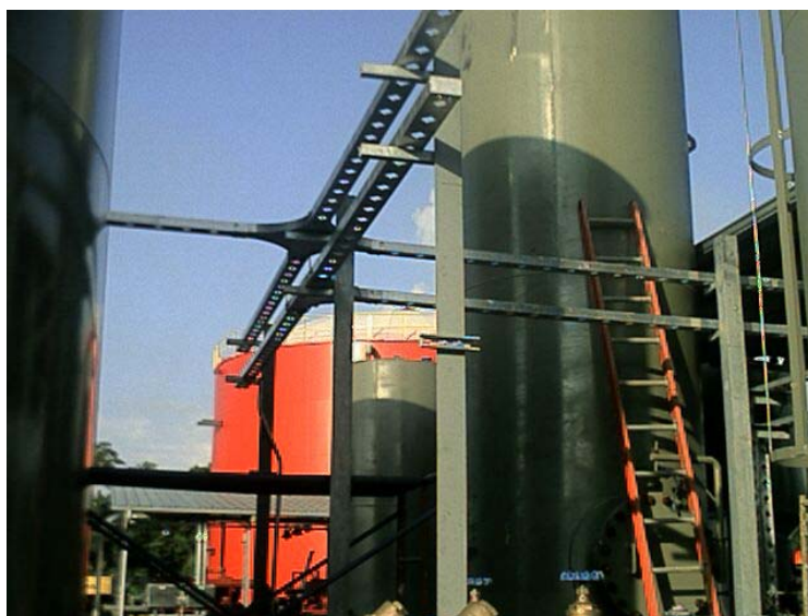
Figura 4. 21 Bandejas porta cables de potencia e instrumentación.
