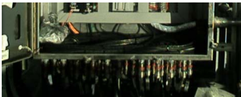
Figura 4. 31 Conectores Hawke en panel de control
