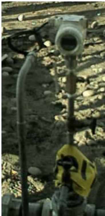
Figura 4. 37 Instalación del transmisor de presión.
