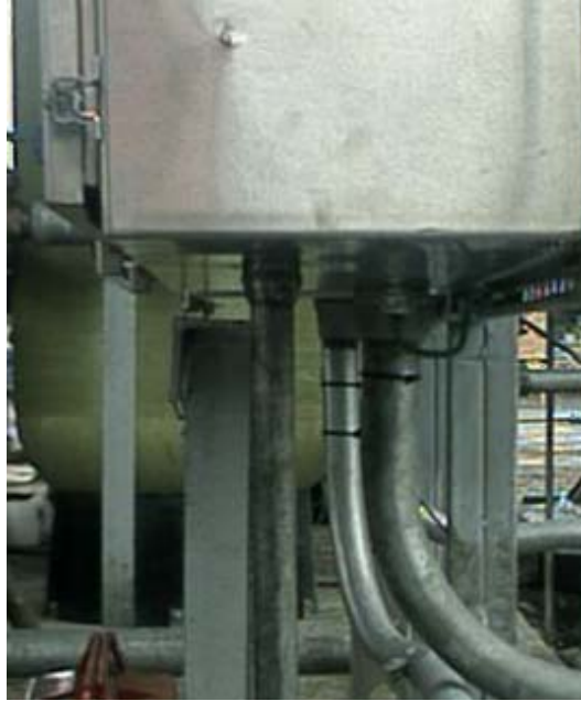
Figura 4. 32 Acometida al panel con conduit
