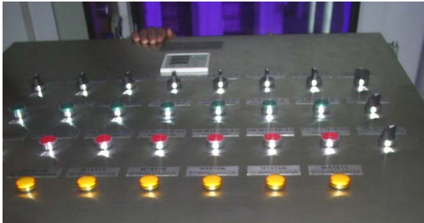
Figura 4. 12 Mandos de control en el panel de arrancadores X-1602
