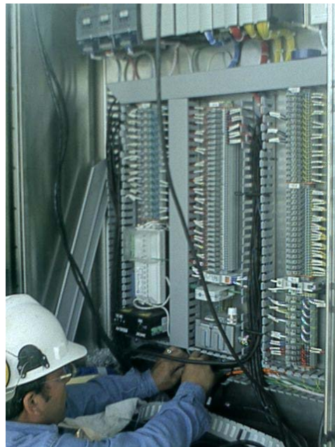
Figura 4. 33 Conexionado interno en panel de control
