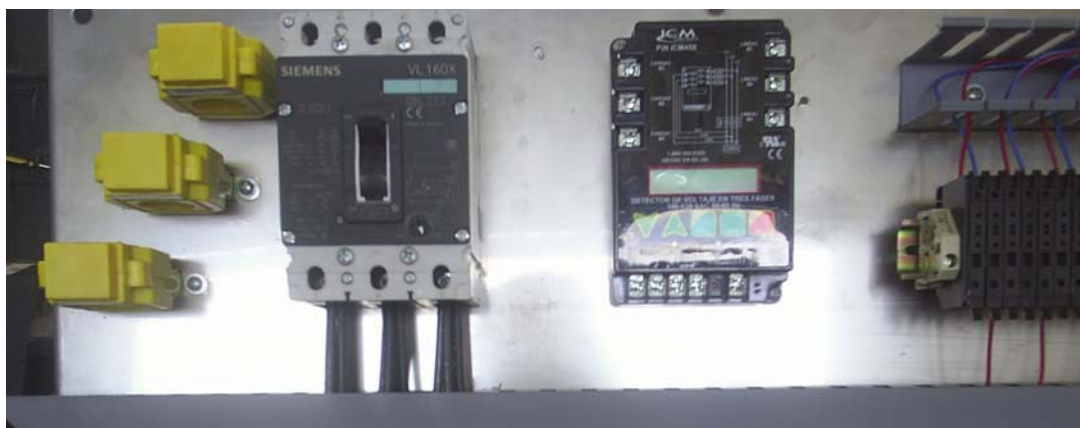
Figura 4. 8 Distribución superior del panel de arrancadores
