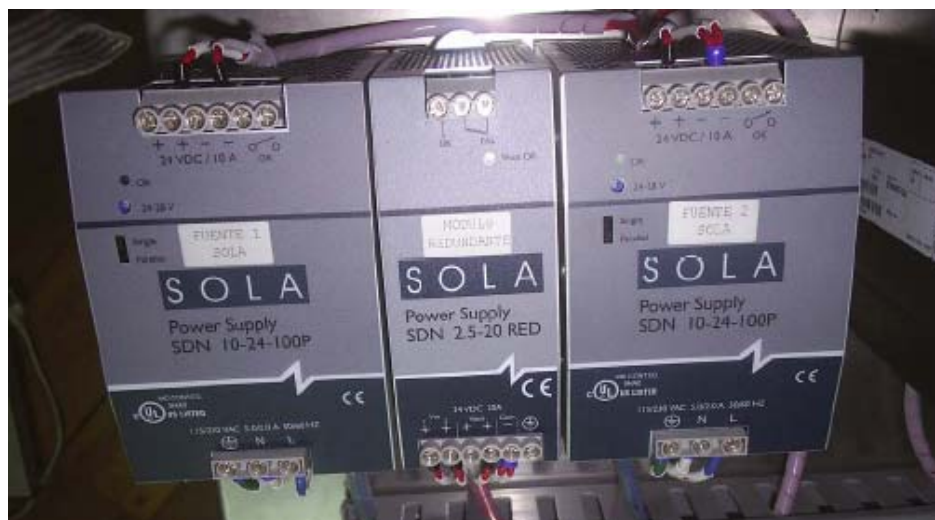
Figura 4. 1 Fuente de poder Sola y módulo de redundancia
