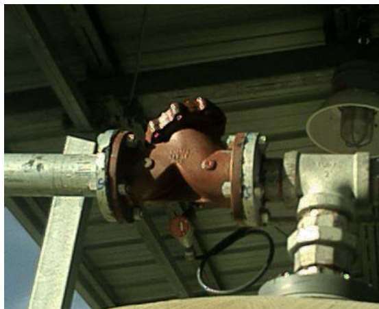
Figura 4. 45 Válvula de diafragma de 2" y válvula solenoide de control
