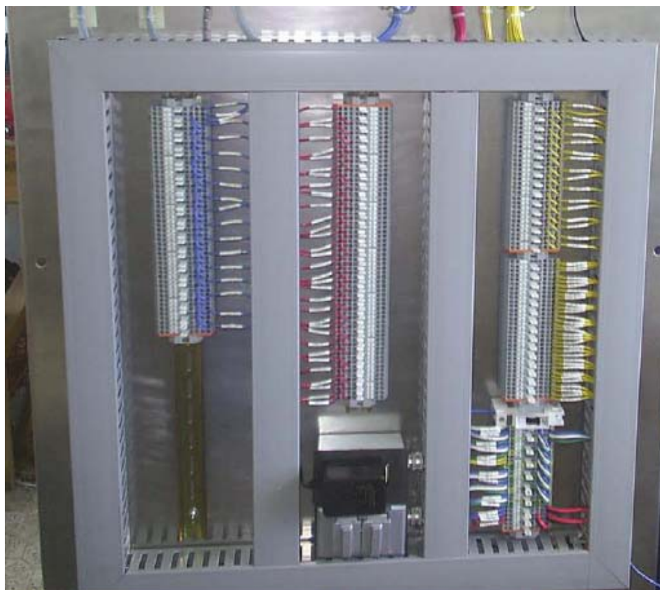
Figura 4. 4 Distribución de canaletas en panel de control
