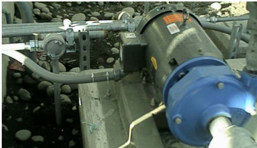
Figura 4. 30 Conexión a caja de motor mediante conduit flexible.
