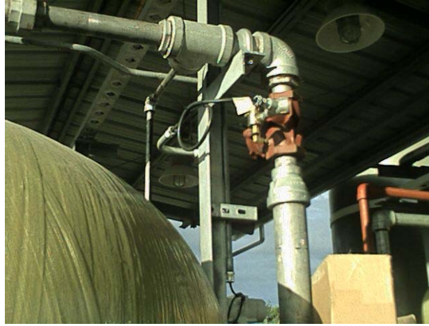
Figura 4.46 Acceso de cable a válvula solenoide
