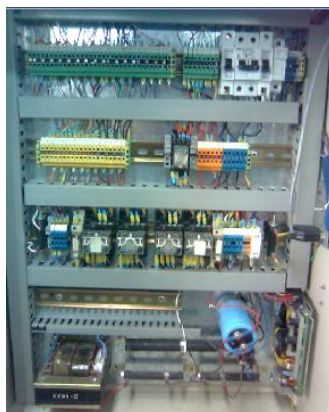
Figura 4.8 Interior Gabinete Eléctrico.
