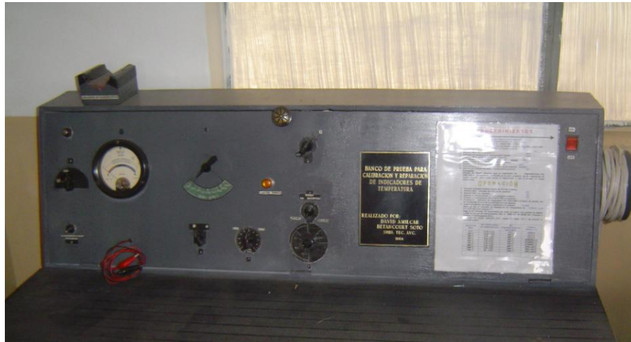
Figura 7.12 Banco de pruebas generador de milivoltios
