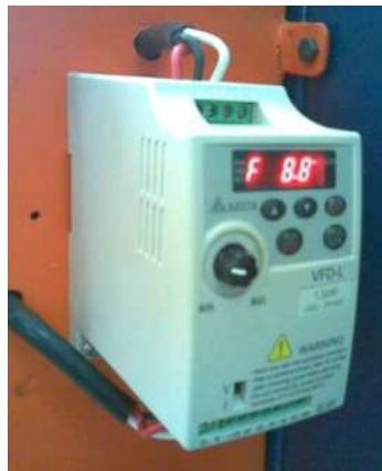
Figura 3.8 Variador de frecuencia
