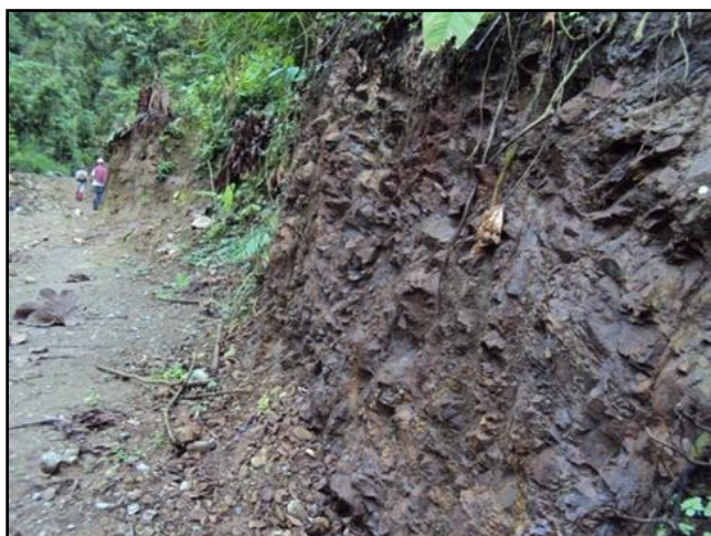
Figura 5.10: Arenisca de aporte volcánico muy fracturada, margen izquierdo Q. Bellavista, UTM: 770199E/19409N (Echeverría et al., 2011)
