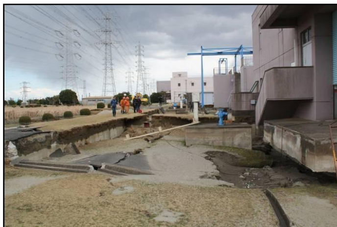
Figura 4.11: Estructuras hundidas por licuefacción, Japón 11 marzo 2011 (Scott Ashford, Oregon State University)
