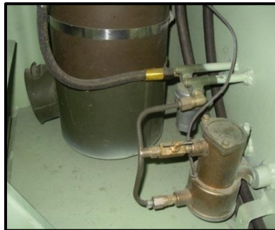
Figura. 4.69 Entrada de combustible
