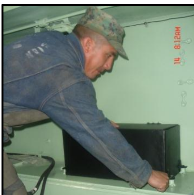
Figura. 4.43 Caja de baterías
