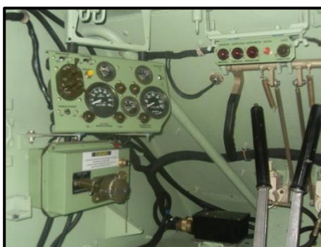
Figura. 4.42 Tablero de control
