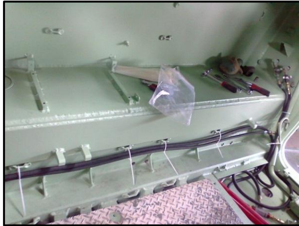
Figura. 4.73 Cañerías de alimentación y retorno de combustible
