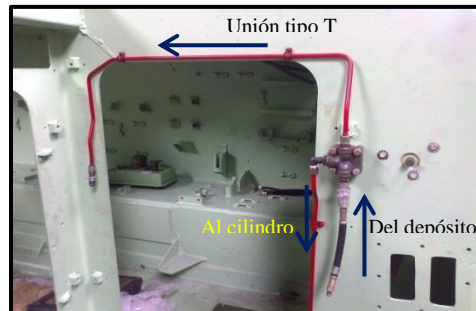
Figura. 4.48 Válvula de control
