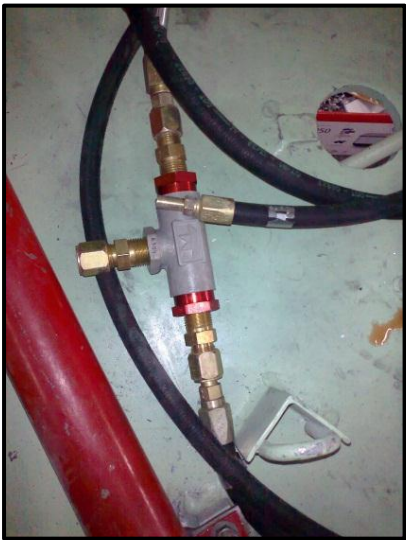
Figura. 4.72 Unión de cañerías de combustible
