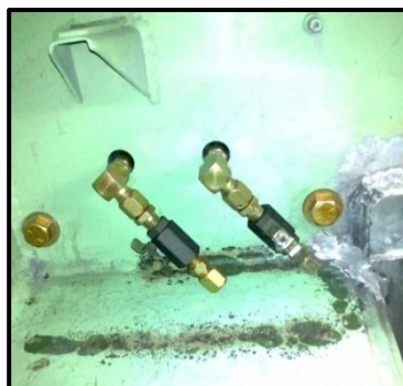
Figura. 4.70 Llaves de paso de combustible
