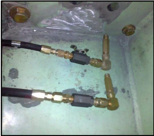
Figura. 4.71 Cañerías de combustible
