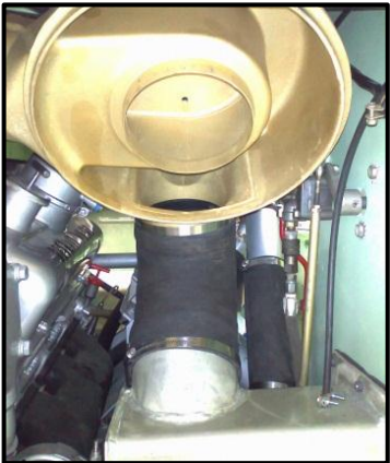
Figura. 4.7 Filtro de aire
