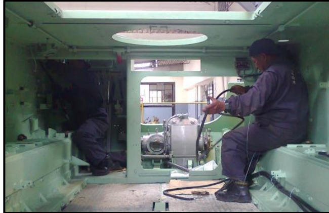
Figura. 4.38 Paso de cables de batería
