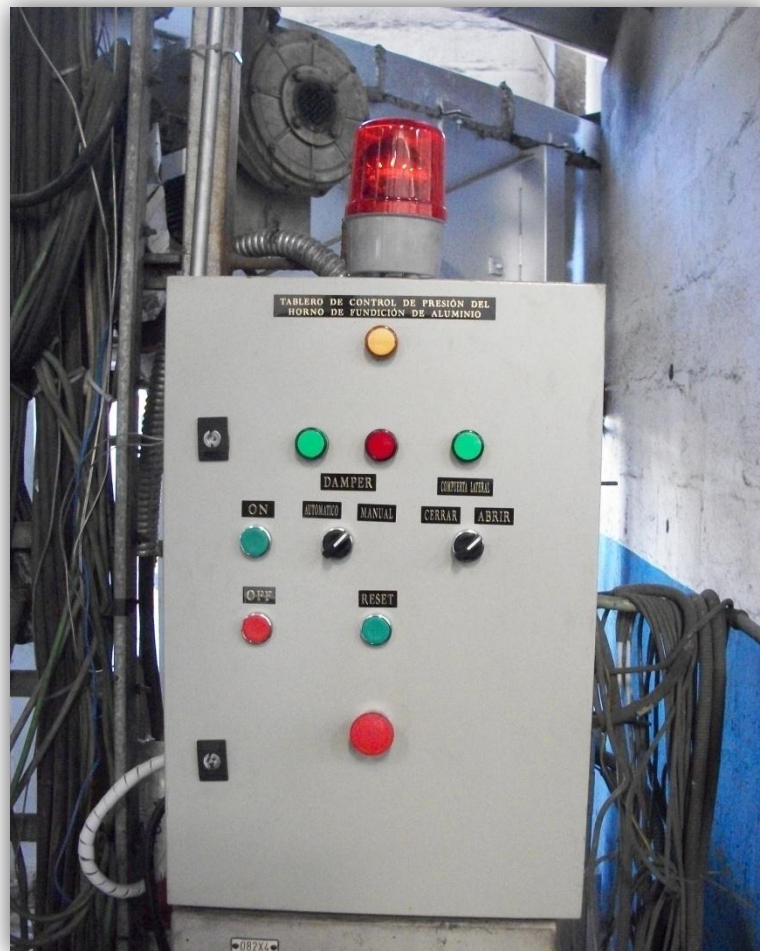
Figura 4-1 Tablero de control de Presión del Horno de Aluminio
