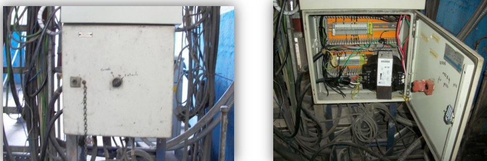
Figura 3-20 Tablero del Transformador
