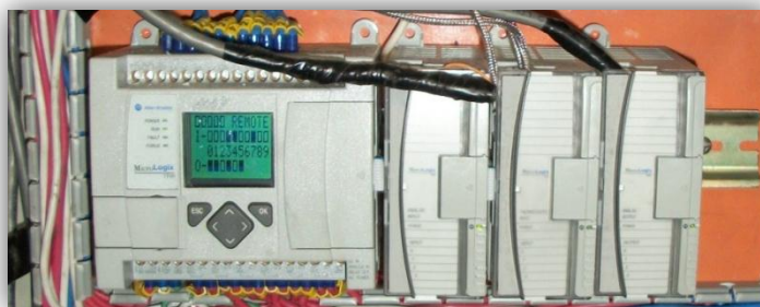
Figura 4-6 Entrada y Salidas del PLC en Ejecución
