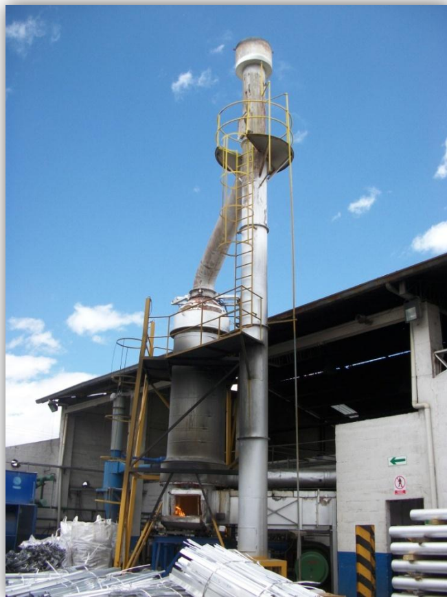
Figura 1-13 Chimenea del Horno de Fundición de Aluminio
