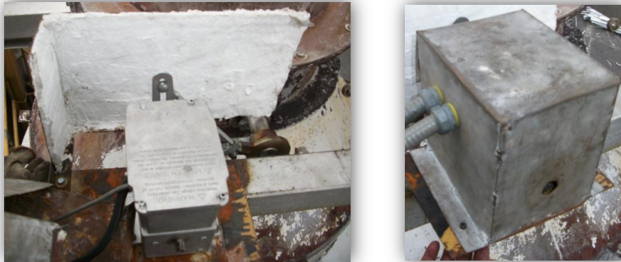
Figura 3-16 Cubierta del Modutrol.
