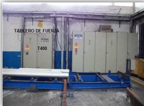
Figura 3-18 Tablero principal de Distribución de Fuerza de la Planta De Fundición.
