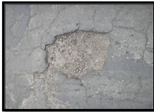
Figura 2. 16 – Bache en la carretera Pujilí - Latacunga.
