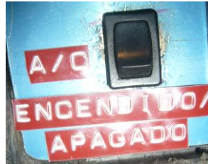
Figura 4.39 Interruptor de control del sistema de aire acondicionado
