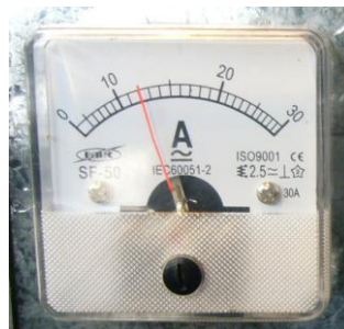
Figura 4.40 Conexión del amperímetro
