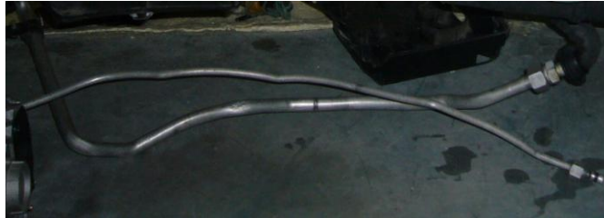
Figura 3.20 Tuberías de aluminio
