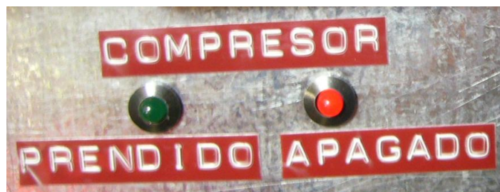
Figura 5.12 Presóstato de baja abierto, compresor apagado
