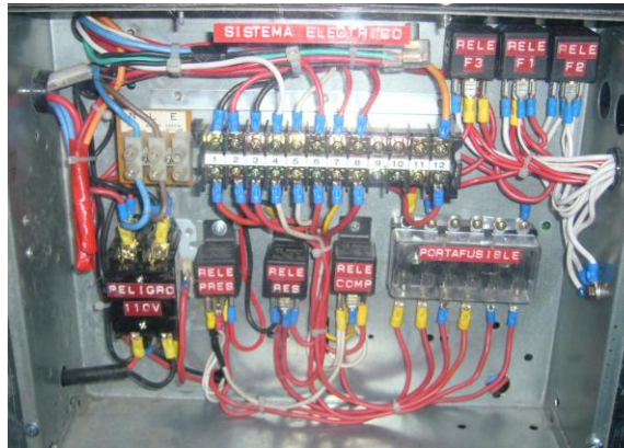
Figura 4.49 Tablero de control del banco simulador
