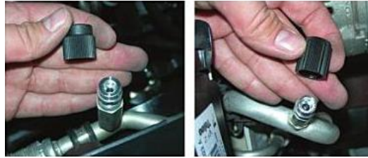
Figura 1.52 Posición de las válvulas de servicio de alta y baja en su respectivo circuito
