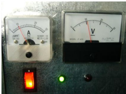
Figura 4.50 Compresor funcionando, led verde prendido
