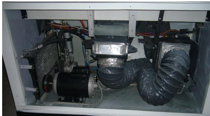
Figura 4.57 Componentes del acondicionamiento de aire del banco simulador
