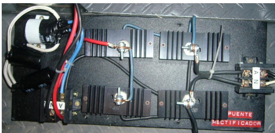
Figura 1.62 Rectificador de voltaje de AC a DC
