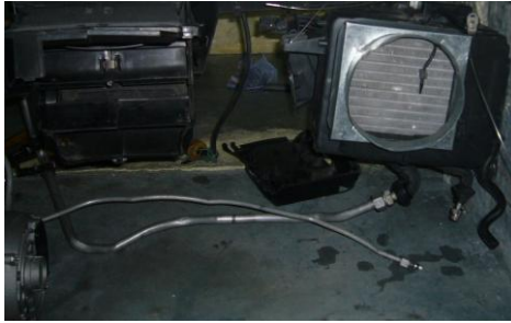
Figura 4.35 Cañerías del sistema de aire acondicionado
