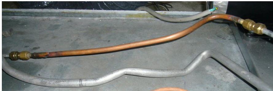
Figura 4.36 Extensión de cañería de cobre
