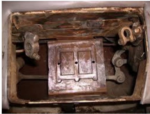
Figura 2.15. Corrosión producto del electrolito.
