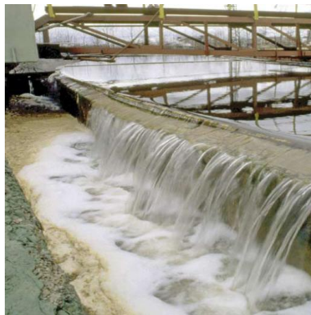
Figura 5.5. Piscinas de tratamiento de aguas residuales
