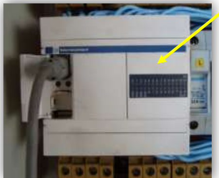
Figura 3.31.- Montaje e instalación del autómata programable (PLC).
