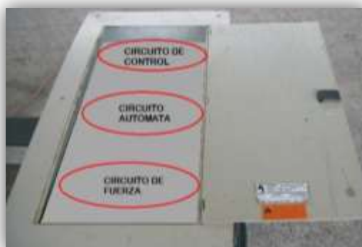
Figura 2.46.- Tablero de control.
