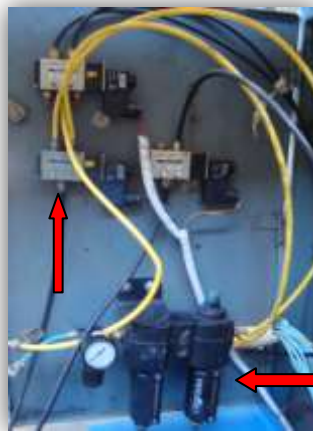
Figura 3.13.- Montaje de electroválvulas y unidad de mantenimiento.
