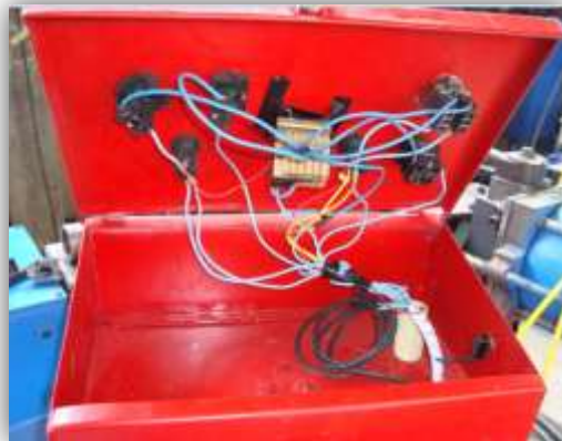
Figura 3.33.- Conexión eléctrica del tablero de mando hacia el de control.
