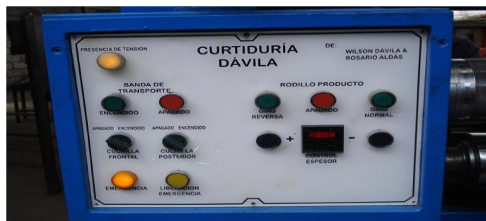
Figura 1 Prueba del sistema eléctrico
