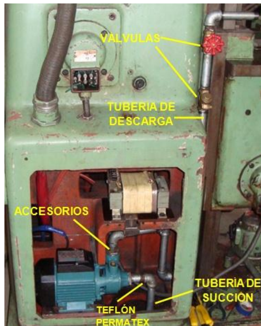
Figura 4.2: Tuberías y accesorios instalados
