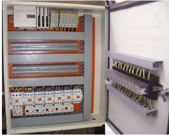
Figura 4.25: Elementos montados en el tablero de control
