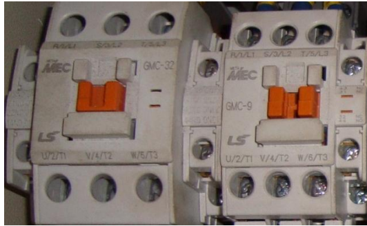
Figura 3.25: Contactor del circuito de fuerza
