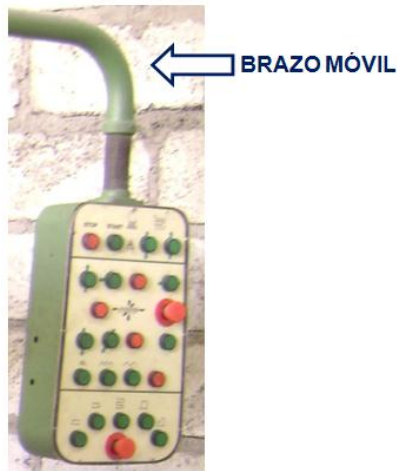
Figura 2.12: Panel Operador de Mando
