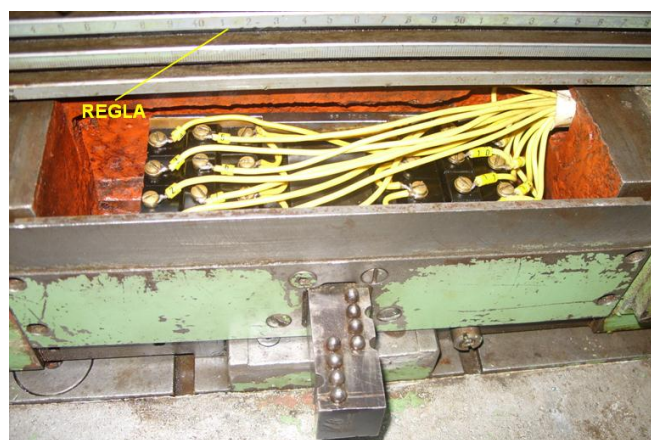
Figura 4.33: Cableado de los finales de carrera
