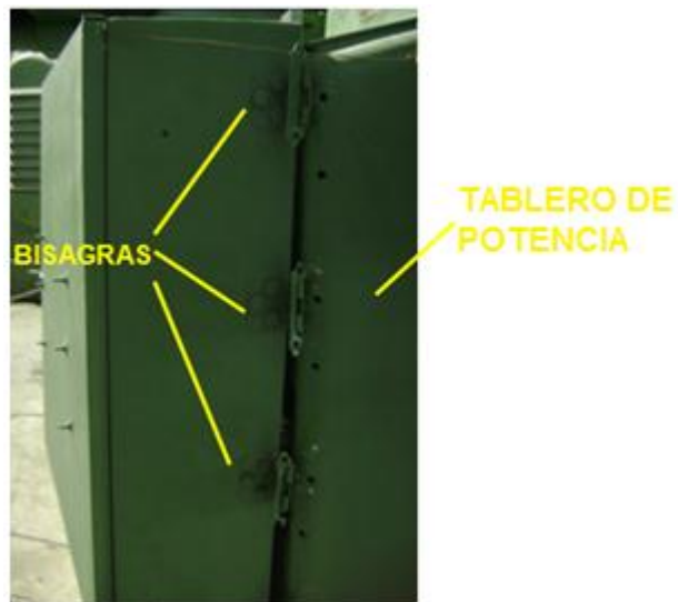
Figura 4.27: Tablero de control contiguo al tablero de potencia
