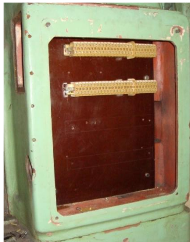
Figura 2.10: Tablero de potencia
