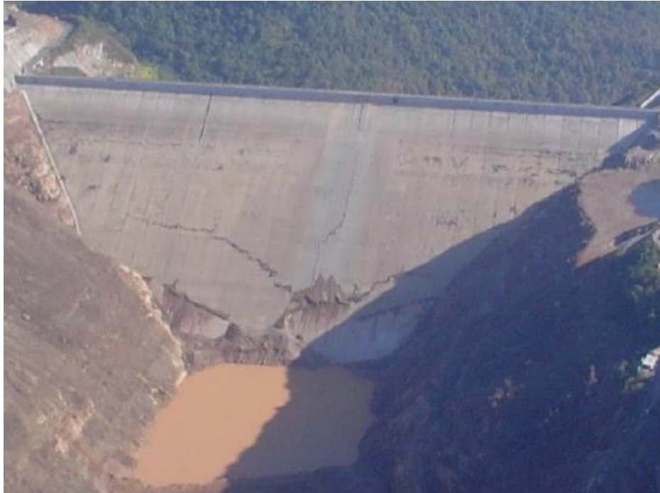
Figura 7 Daño en la pantalla de la Presa Campos Nova en Brasil. INGETEC (2007)
