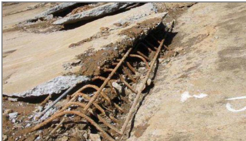
Figura 1.25: Fallas de la presa Campos Novos (Fuente: Hermann, Grossi & Balaguer et al, 2008)
