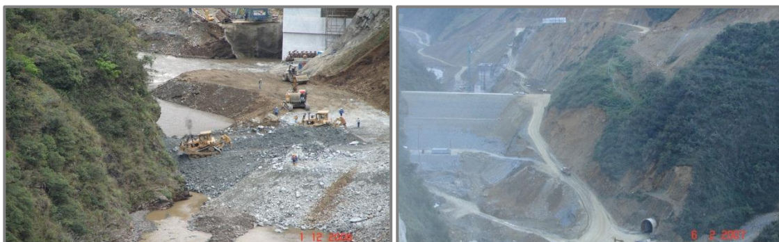
Figura 2.82: a) Creación pre-atagüía aguas arriba de la Presa Mazar, b) Construcción atagüía definitiva aguas arriba de la Presa Mazar (Fuente: Caminosca, 2011)
