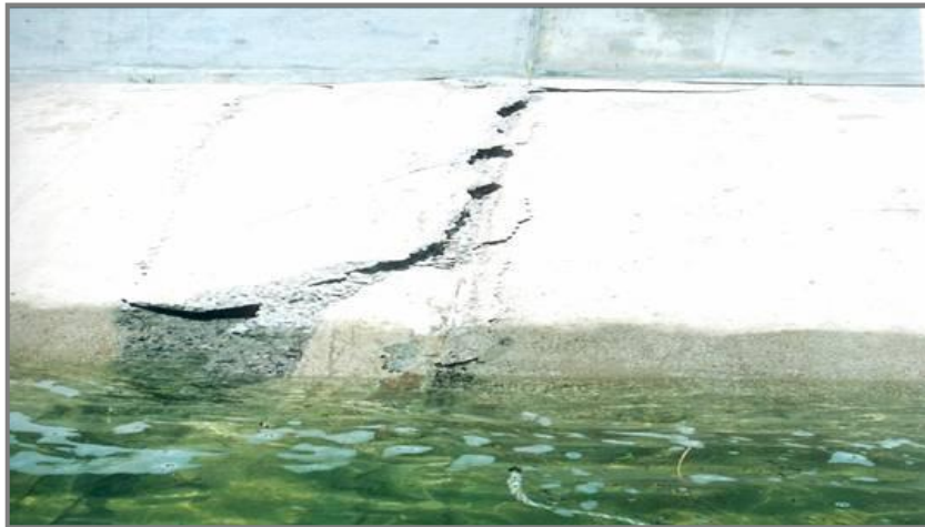
Figura 1.29: Falla de la presa Mohale (Fuente: lhwp.org.ls)
