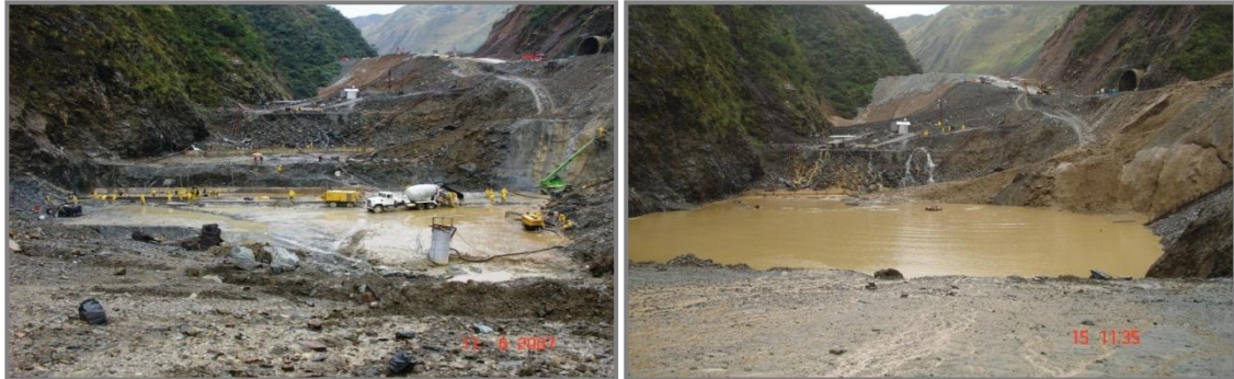
Figura 2.88: Paralización de los trabajos debido al deslave durante invierno
