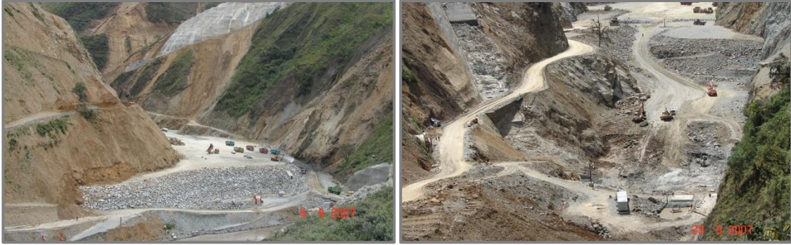
Figura 2.89: a) Colocación de material 3C y protección, b) Excavación del lecho aguas arriba de la presa (Fuente: Caminosca, 2011)
