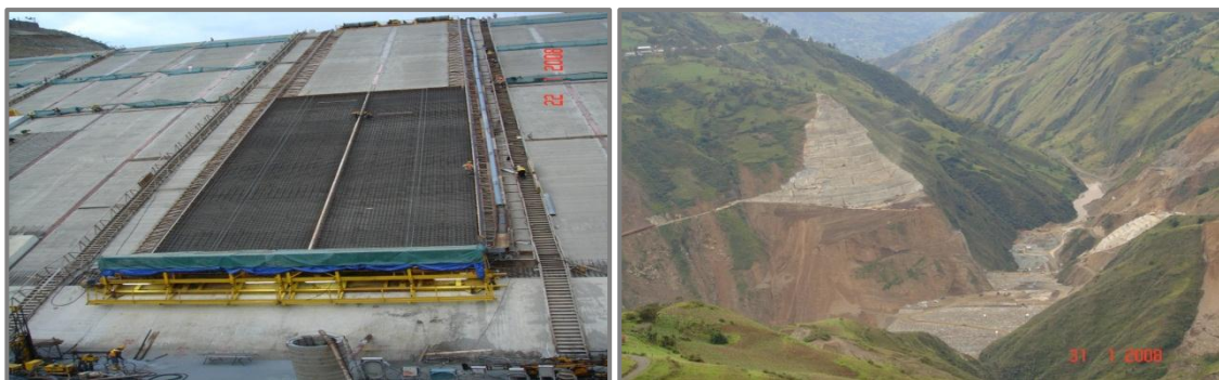
Figura 2.94: a) Armadura de la losa, encofrado deslizante y tubería de alimentación del hormigón, b) Excavación y estabilización de los taludes en la zona donde fue construido el vertedero (Fuente: Caminosca, 2011)
