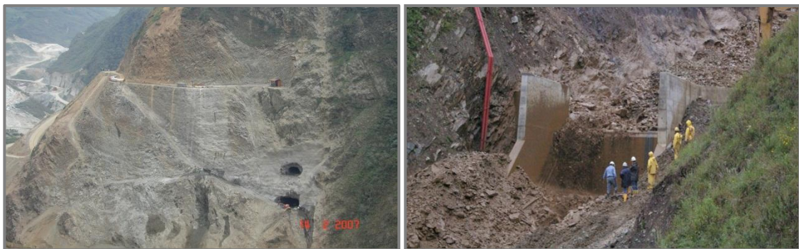
Figura 2.87: a) Excavación del plinto del margen derecho y de los túneles de carga y de desagüe de fondo, b) Destrucción de una parte de la obra de desagüe de la quebrada de Ingapata durante un deslave en invierno (Fuente: Caminosca, 2011)
