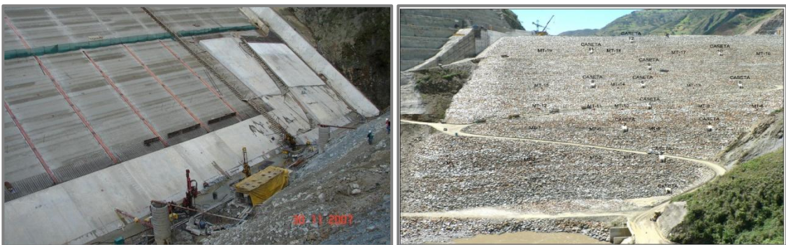
Figura 2.91: a) Construcción losas de arranque, b) Casetas de instrumentación y mojones topográficos (Fuente: Caminosca, 2011)
