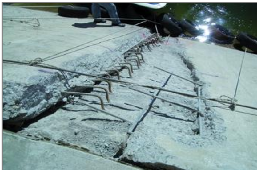
Figura 1.28: Falla de la presa Mohale (Fuente: waterpowermagazine.com)
