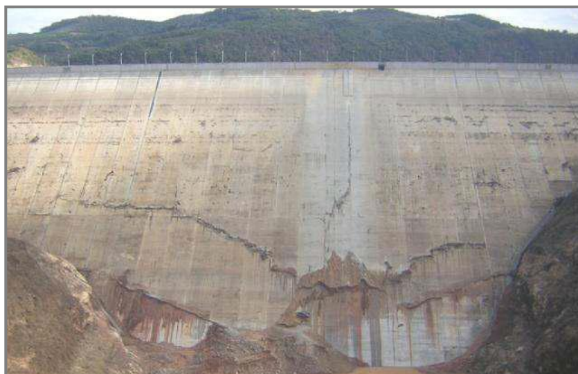
Figura 1.24: Fallas de la presa Campos Novos (Fuente: Hermann, Grossi & Balaguer et al, 2008)
