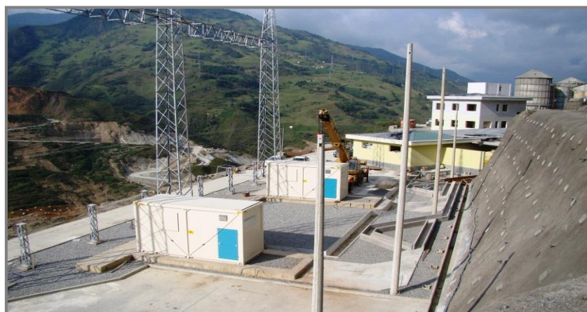
Figura 2.19: Patio de maniobras - subestación SF6 (Fuente: Caminosca, 2011)
