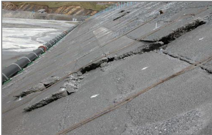
Figura 1.26: Falla del bordillo de la presa Antamina (Fuente: Ingetec, 2007)
