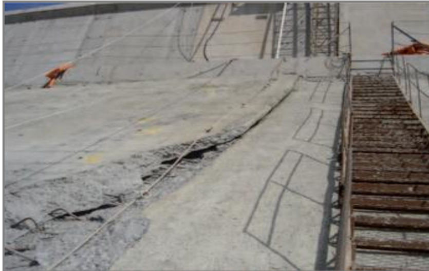
Figura 1.27: Falla de la presa Barra Grande (Fuente: waterpowermagazine.com)
