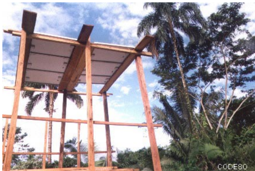
Figura 1.4. Paneles Isofotón instalados por CODESO en la comunidad Chiwias
